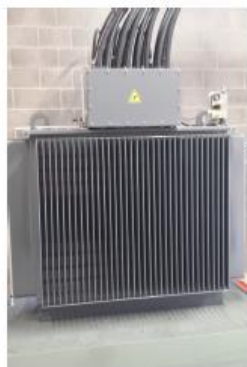
Transformateur 1600 KVA 20 KV/400 V
